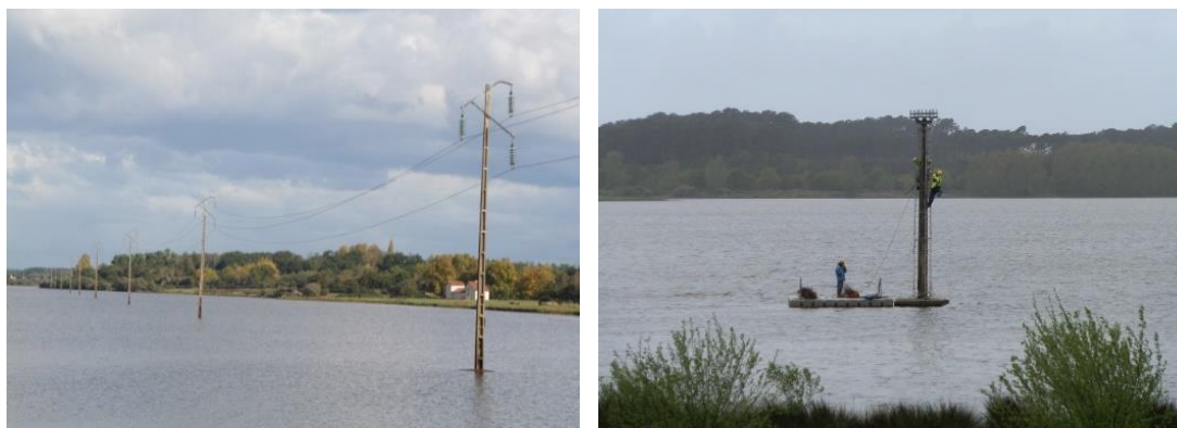
Figures 17 et 18 : Ancienne ligne électrique de haute tension traversant la RNN du Marais d'Orx aménagée en plateforme
